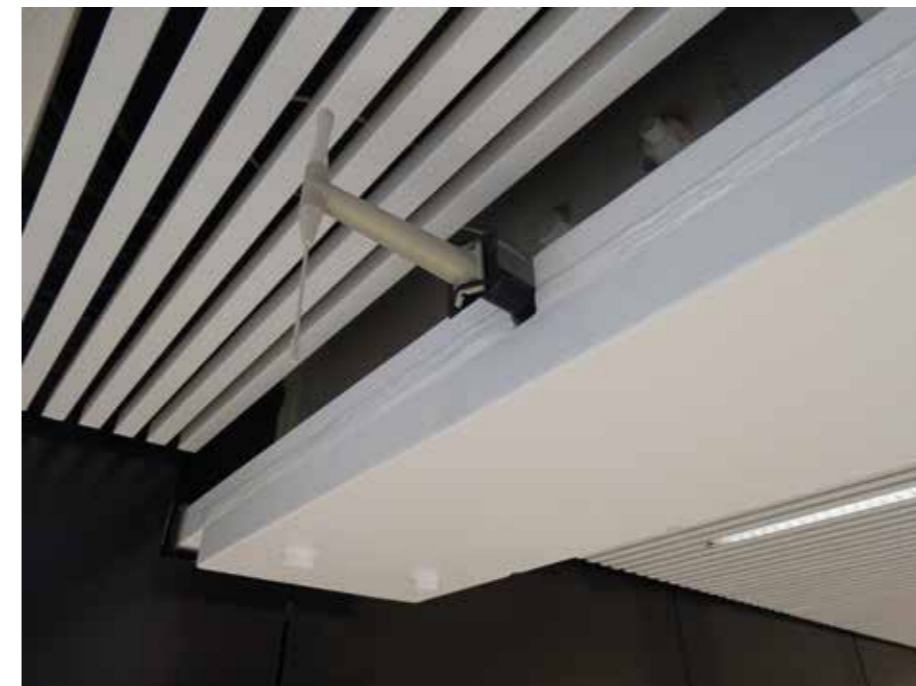
Eén van de vier in het Timmerhuis geïnstalleerde antennes.
